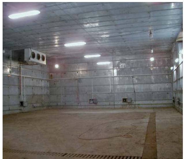
Obr. 1.46 Velkoškola Kladíkov, klimatizovaný sklad sadebního materiálu lesních dřevin – pohled do jedné z vyprázdněných hal po ukončení sezóny. (Foto autor)
